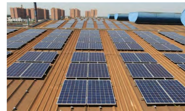
光伏发电系统
